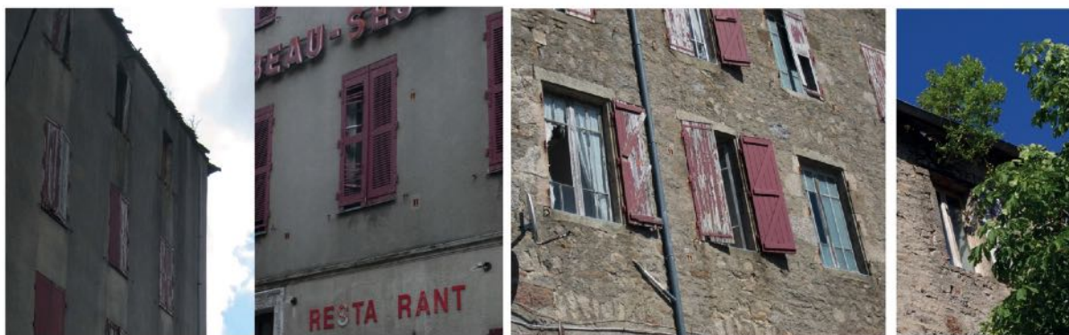
Vues montrant l'état de dégradation du bâtiment
