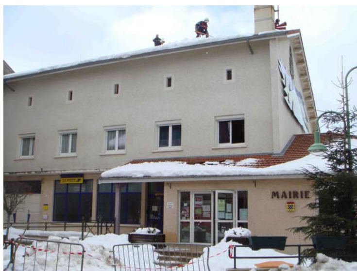
Dégâts occasionnés lors du dégel par la chute de plaques de neige
