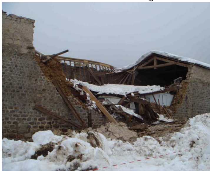
Quand le poids de la neige fait s'effondrer les toits
